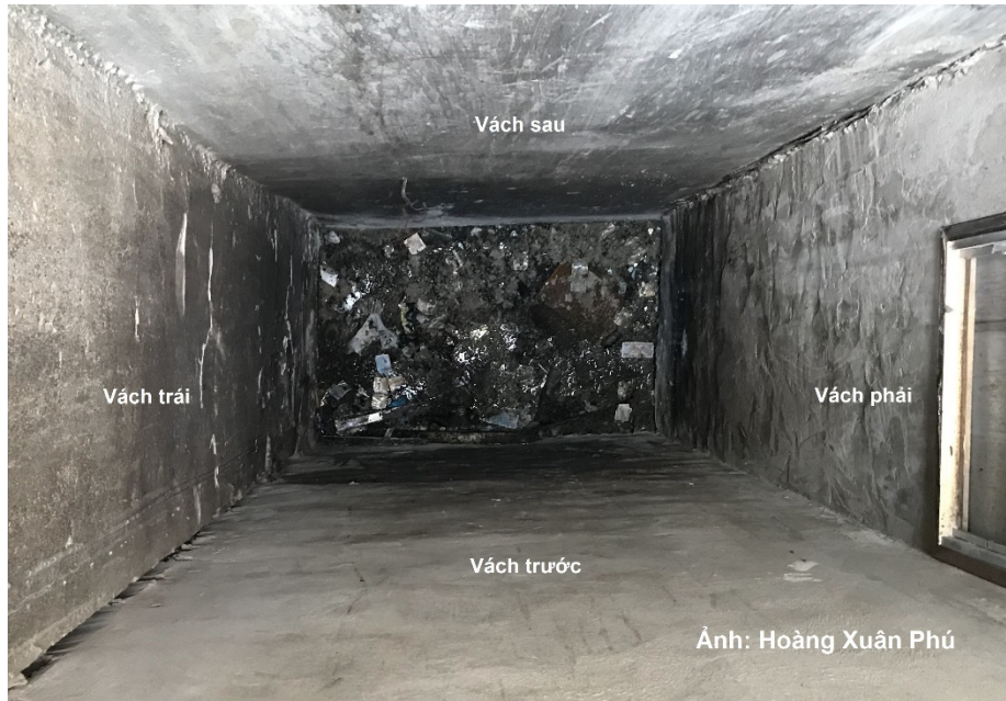
Ảnh 2.1: Dấu vết vụ cháy trong hố kỹ thuật
